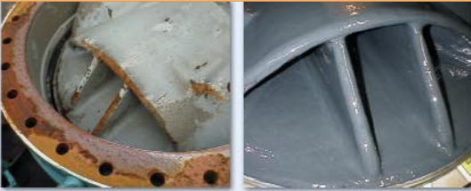
A korrodált pillangószelep – felújítás előtt és után
